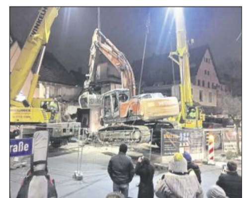
Bei Abbrucharbeiten am ehemaligen Modehaus Veil brach der Bagger ein. Foto: ZVW
